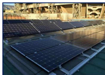
Impianto Fotovoltaico allestito presso il CNR – Istiti
